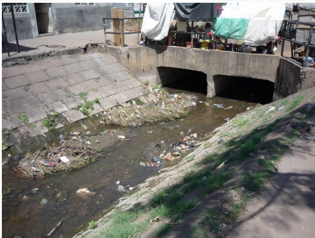
Figura 3-36: Principal canal de águas pluviais ao longo da Av. Acordos de Lusaka no Bairro Maxaquene A com um “caudal de base” de aprox. 10 l/s águas residuais domésticas e com depósitos de resíduos sólidos.
