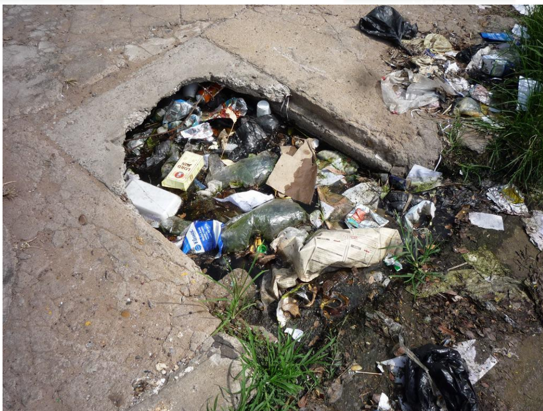
Figura 3-44: Entrada de águas pluviais na cidade de cimento de Maputo: bloqueada por resíduos sólidos
