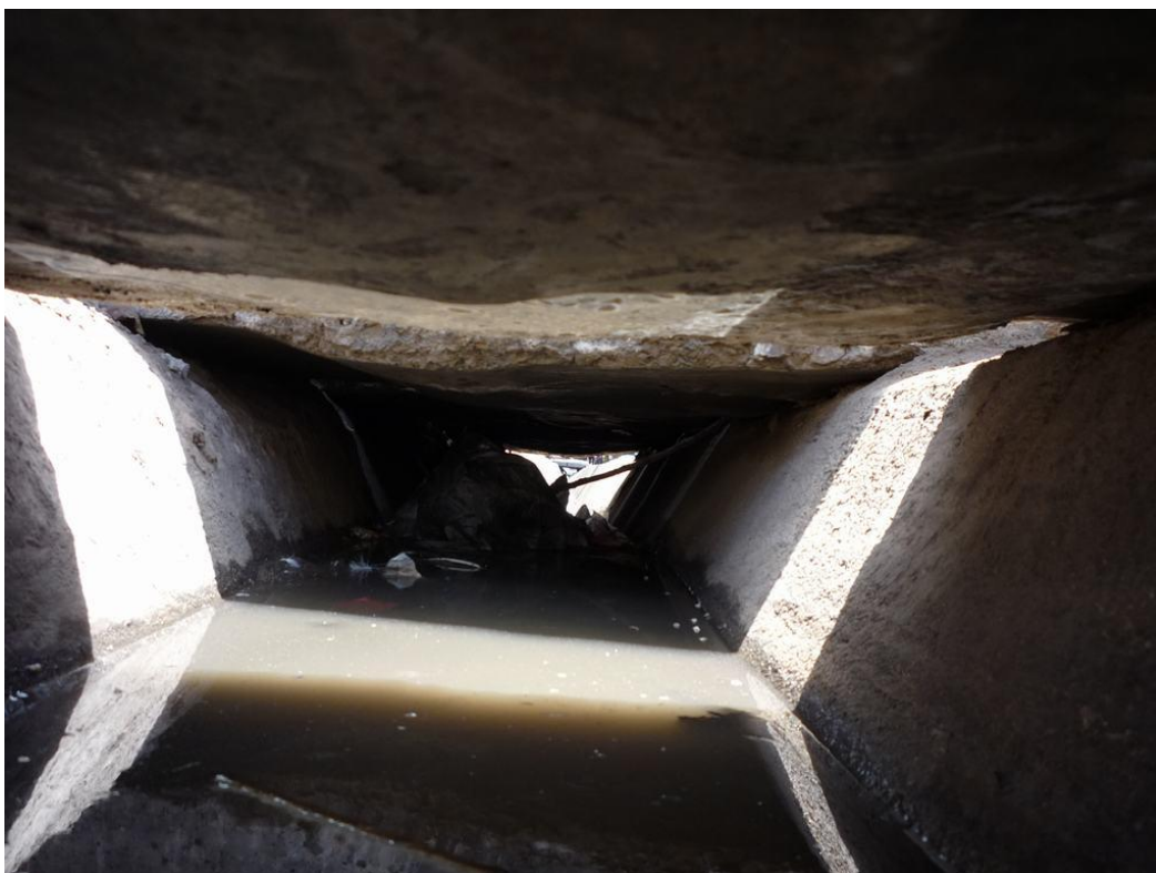
Figura 3-49: Canal secundário no Bairro Mafalala. Bloqueado por baixo das lajes de betão que foram colocadas sobre o canal para passagem pedonal
