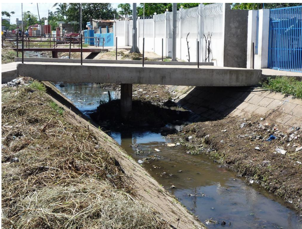
Figura 3-37: Ponte sobre o canal de águas pluviais ao longo da Av. Acordos de Lusaka que serve de canaleta parcialmente bloqueada devido aos depósitos de resíduos sólidos volumosos
