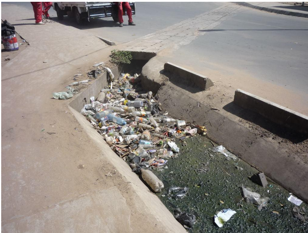
Figura 3-38: Canal secundário no Bairro Maxaquene A, desactivado devido ao bloqueio por resíduos sólidos
