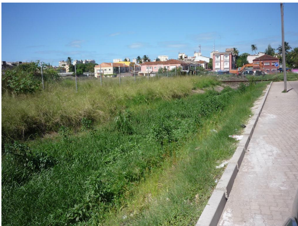
Figura 3-43: Canal de águas pluviais, completamente bloqueado por vegetação
