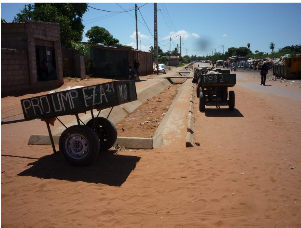
Figura 3-55: Canal secundário no Bairro Sommerschield, bloqueado por sedimentos.
