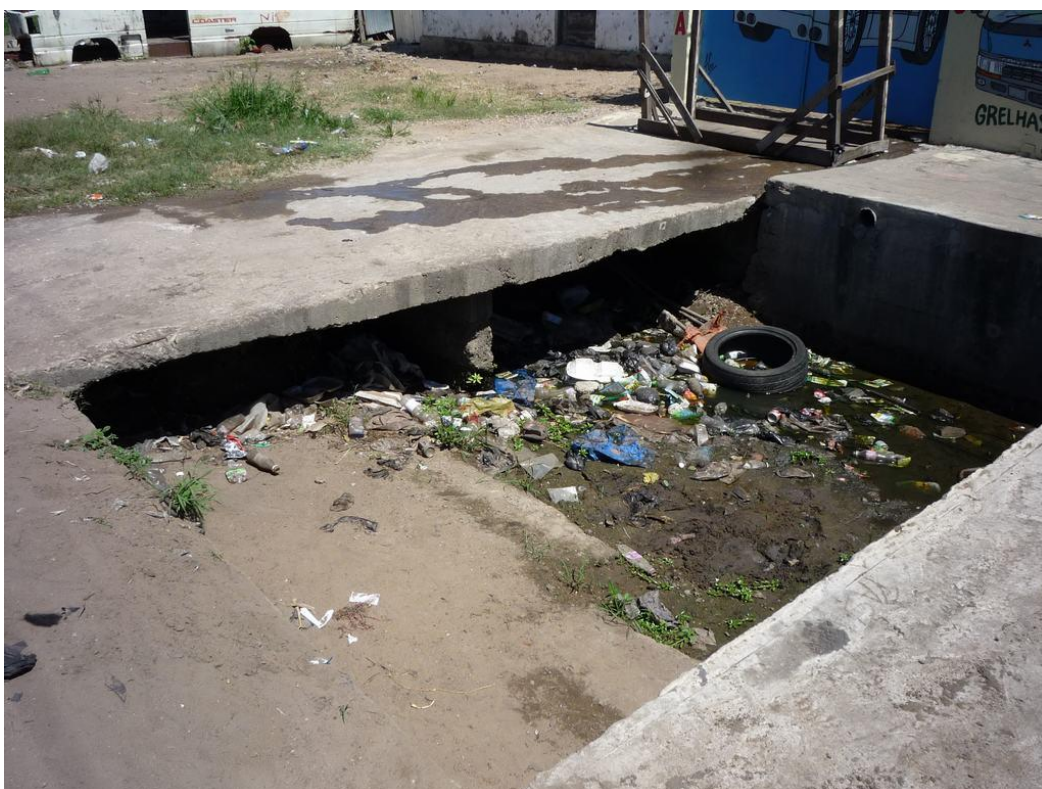
Figura 3-51: Canal secundário no Bairro Maxaquene. Quase completamente bloqueado por resíduos sólidos
