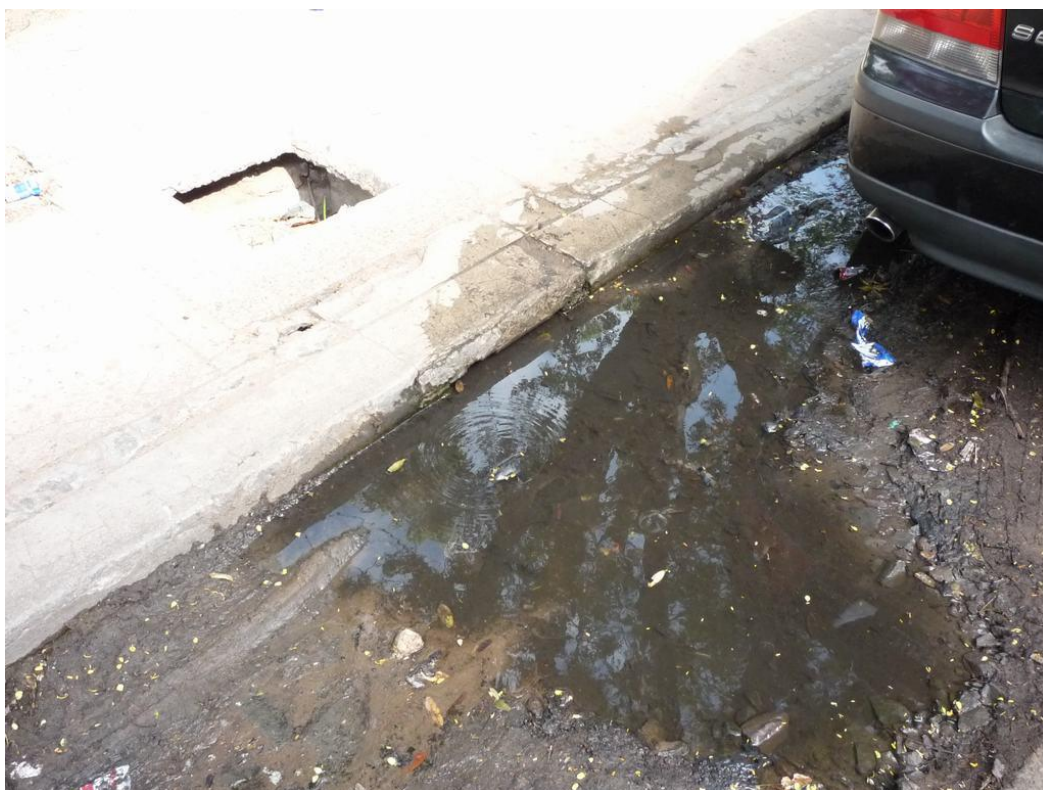
Figura 3-47: Entrada de águas pluviais na cidade de cimento de Maputo: bloqueada, água não entra no sistema de esgotos
