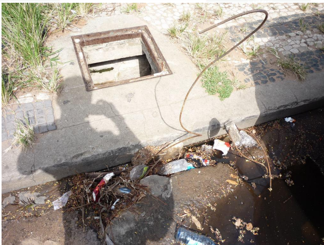
Figura 3-46: Entrada de águas pluviais na cidade de cimento de Maputo: bloqueada por resíduos sólidos
