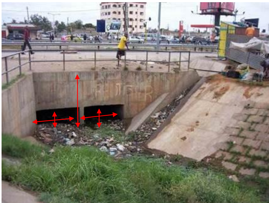
Figura 3-16: Canaleta no cruzamento Av. Joaquim Chissano / Av. Acordos de Lusaka
