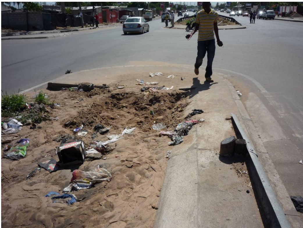
Figura 3-40: Parte à montante do principal canal de águas pluviais na Av. Joaquim Chissano (vista de jusante), completamente bloqueado por sedimentos
