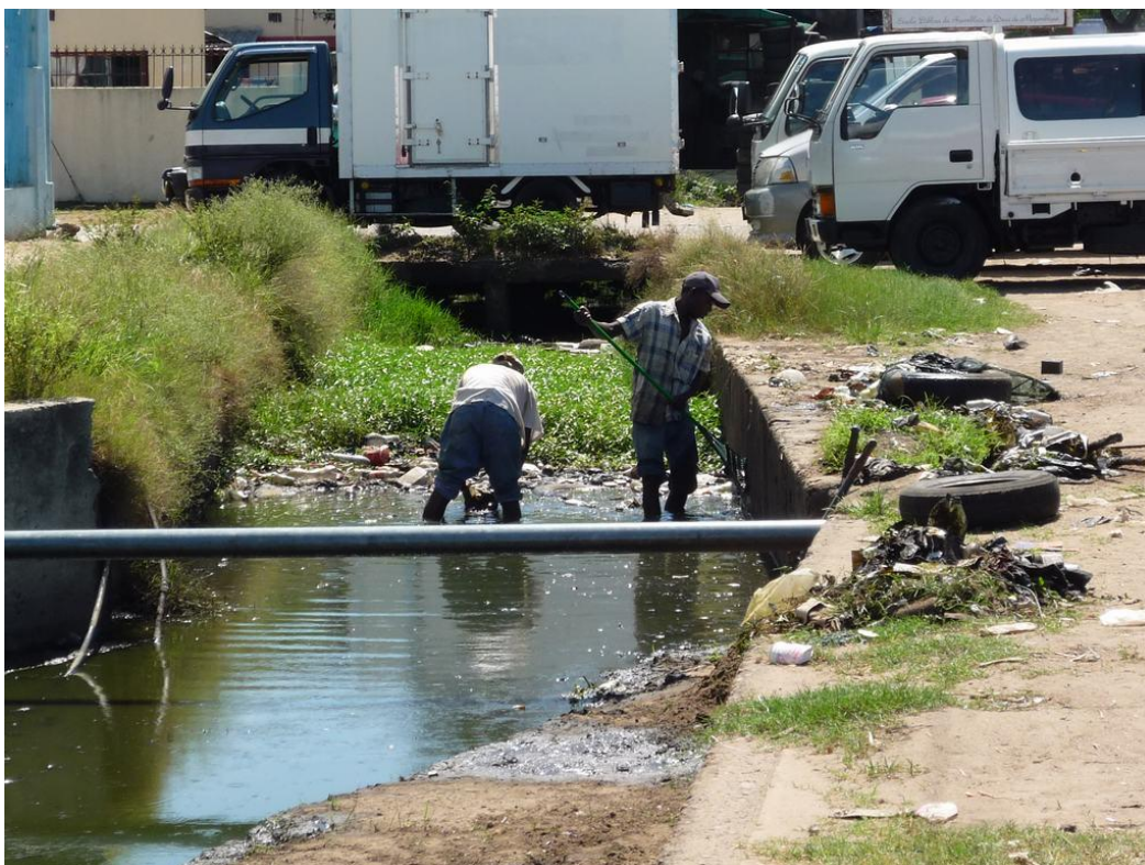
Figura 3-53: O mesmo que acima. Os trabalhadores que estão a limpar o canal não possuem ferramentas adequadas para o limparem devidamente.
