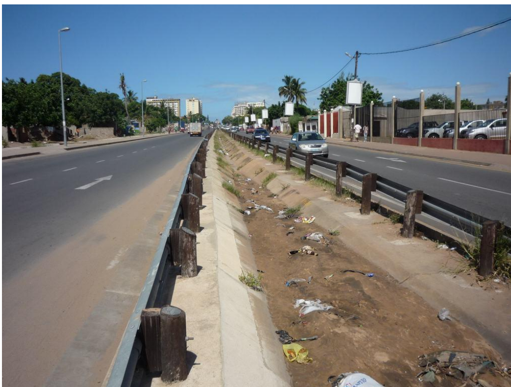
Figura 3-39: Parte à montante do principal canal de águas pluviais na Av. Joaquim Chissano (vista de jusante), completamente bloqueado por sedimentos
