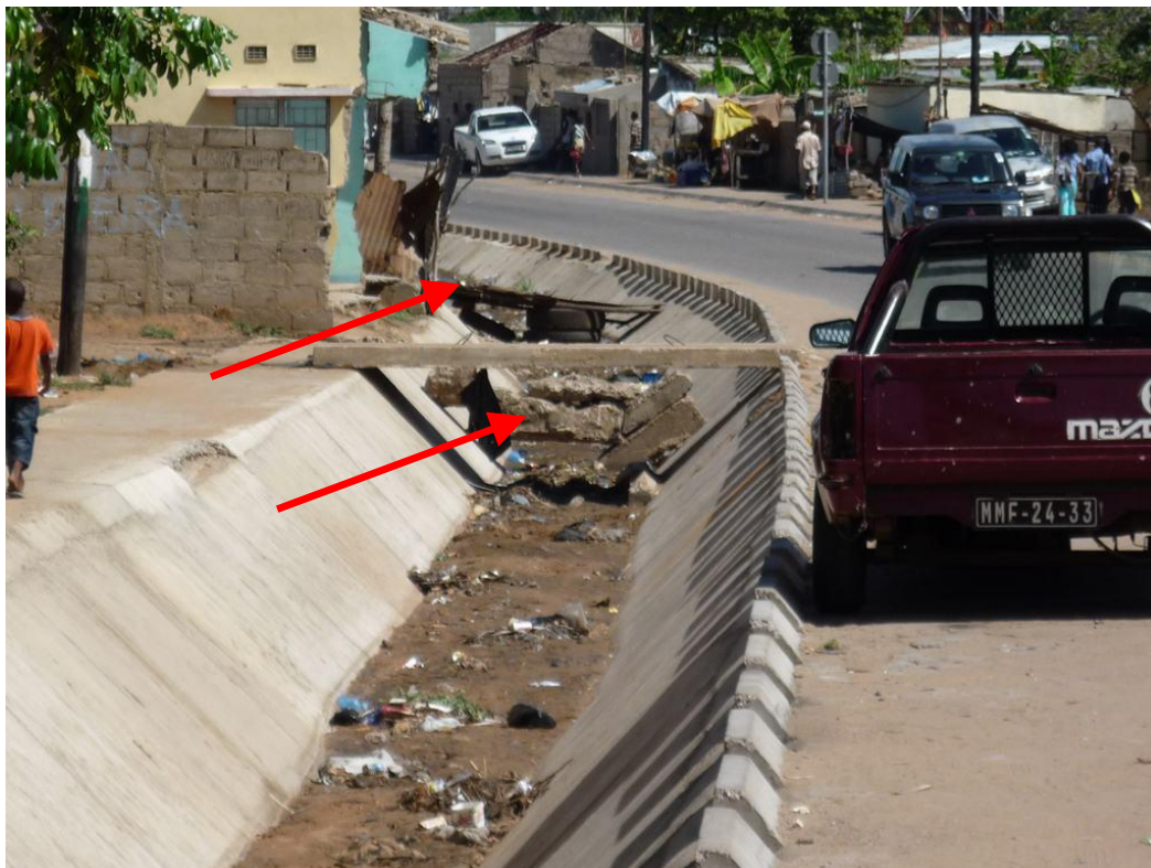
Figura 3-42: Canal secundário no Bairro Maxaquene: bloqueado intencionalmente pelos moradores para obter acesso as suas residências
