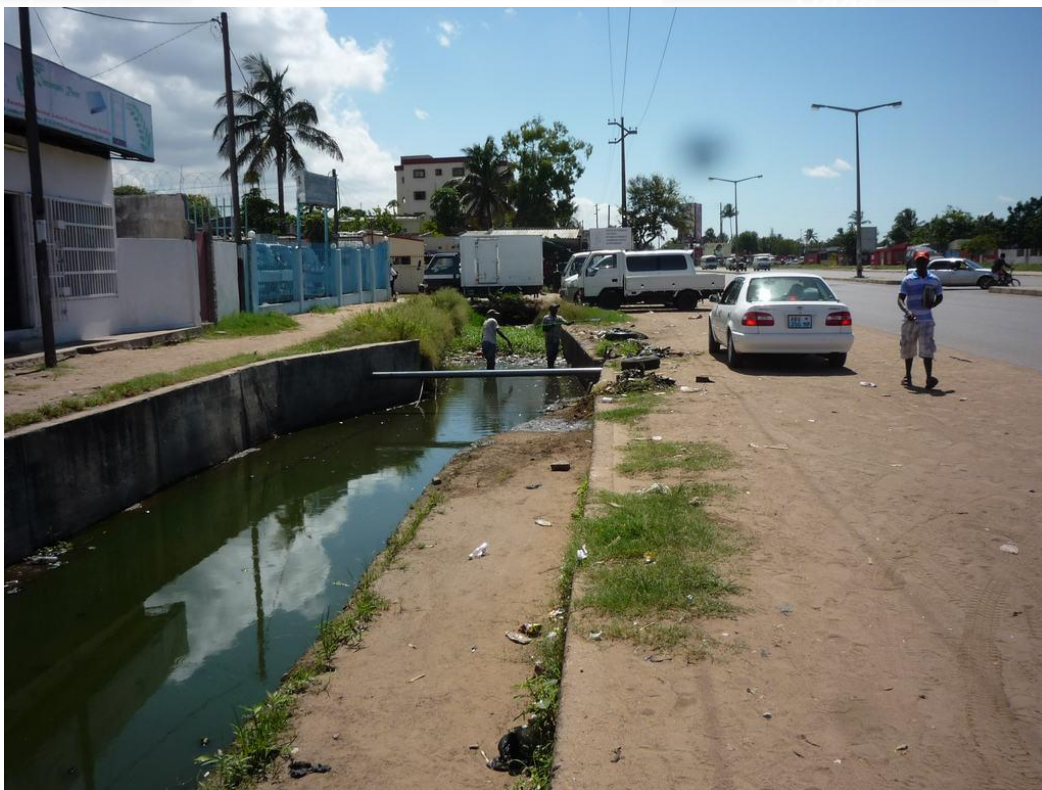
Figura 3-52: Canal de drenagem próximo ao Bairro Mafalala, bloqueado por resíduos sólidos e vegetação.
